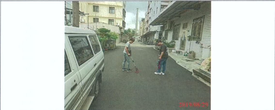
相片(5) 工區九 東區樂成里育英路23巷(東英二街~育英路)路面改善工程
